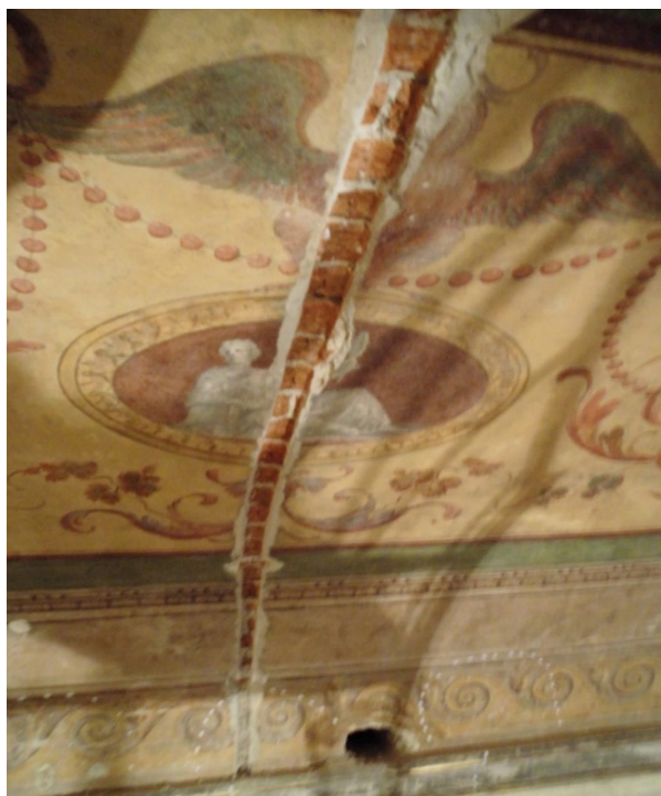
Foto 17 – Traccia preesistente eseguita per passaggio di cavi elettrici
