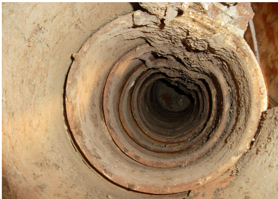
Figura 36: L'interno della tubazione del bagno realizzato da Filippo Cerretani
