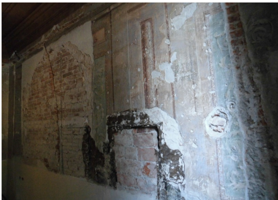
Foto 24 – Parete con grossa lacuna pittorica e presenza di porta richiusa
