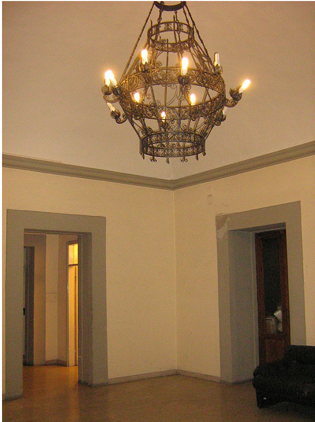
Foto 10 – Sala delle Virtù prima del restauro
