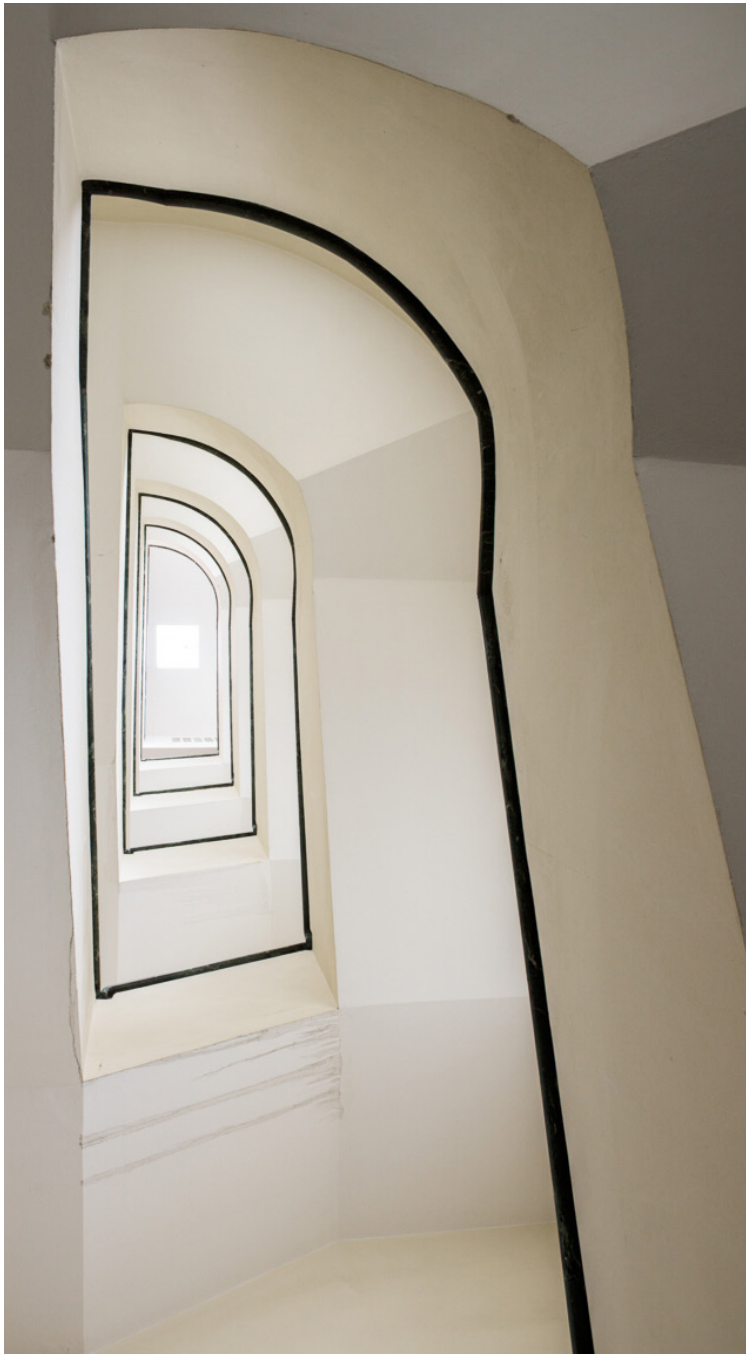
29a. Vano scala, stato attuale, particolari architettonici in marmo bianco unito Apuano, in Brecciato Vagli giallo oro ed in verde Issoria
