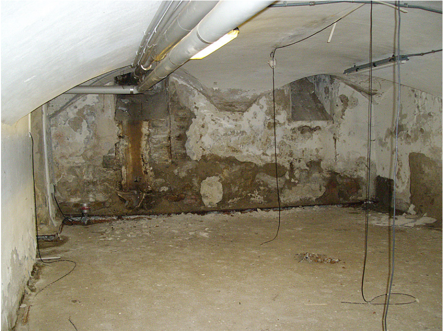
Foto 2 – Stato di forte degrado del piano interrato
