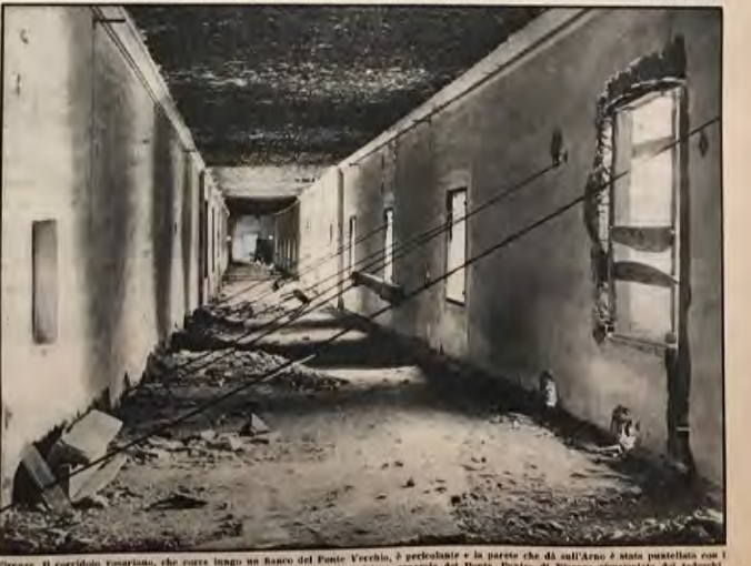
Firenze. Il corridoio vasariano, che corre lungo un fianco del Ponte Vecchio, è pericoloso e la parete che di nell'Arno è stata puntellata con i tramei d'acciaio che si vedono nella fotografia. In alto è visibile una trincea generale del Ponte, l'unico di Firenze risparmiato dai tedeschi.
